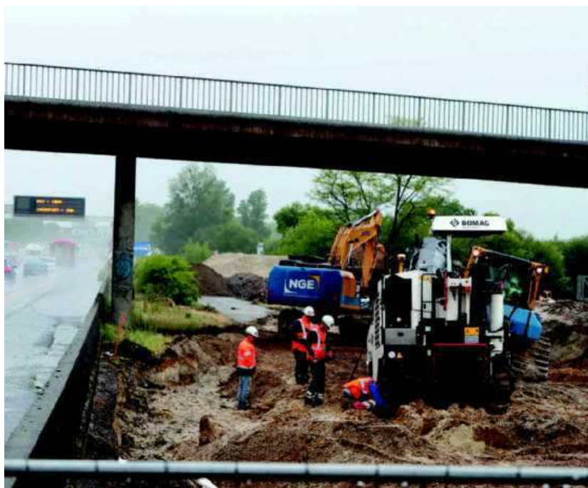
Les pelleteuses ont défriché le terrain et enlevé quelques arbres le long de la rocade
